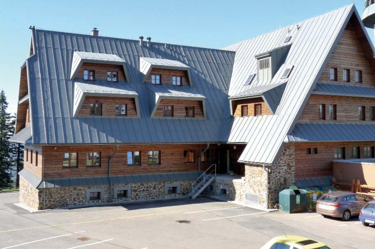
44| Orlické hory – rizikové řešení členité střechy s množstvím detailů (střešní okna, vikýře a podokapní žlab v úžlabí) a navazujícími komunikačními prostory (pod úžlabím vstup do objektu pro zásobování a parkoviště)
