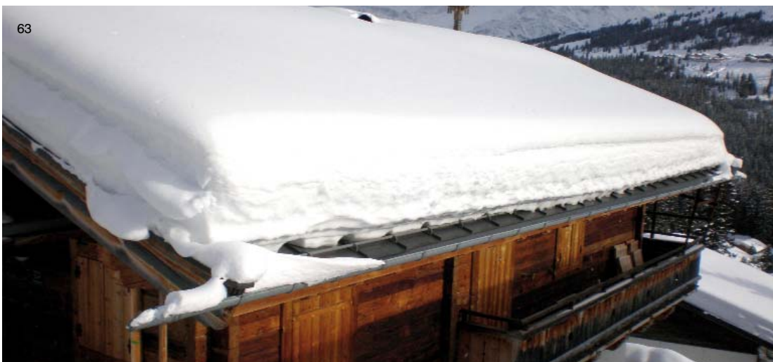
63 | Alpy – na namáhání podokapního žlabu má velký vliv vzduchotěsnost skladby, tepelný odpor skladby, typ a rozmístění sněhových zachytávačů, typ a barva krytiny a sklon střechy. Pro zadržení sněhu na střeše a snížení rizika namáhání detailu okraje střechy jsou příznivější nižší sklony střech
