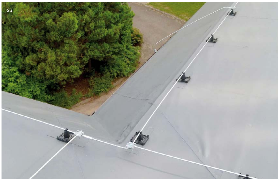
26 | Pohled na okraj střechy jejíž žlab při dešťových přívalech přetéká viz /obr. 27/ [6]
