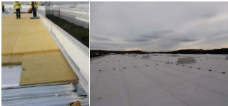
09| Ukončení hydroizolace na zateplených obvodových panelech Kingspan s ukázkou její finální podoby na střeše
