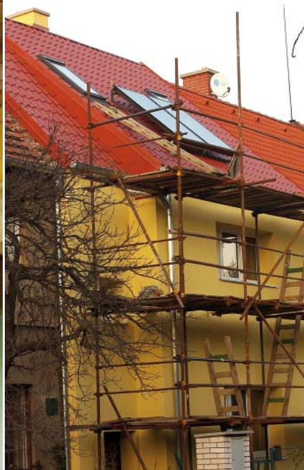
19| Osazení solárních systémů na staré krově je vhodné z důvodů zadržování sněhu realizovat co nejvýše hřebeni. V tomto případě tomu tam nebylo.
