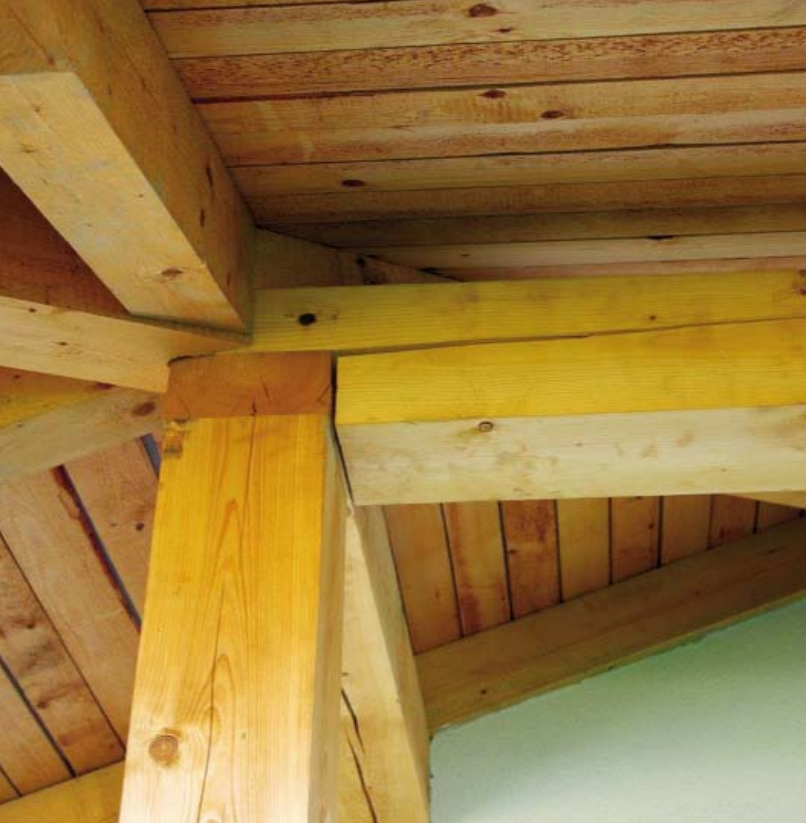
18| Výsušná trhlina ovlivňující únosnost vaznice
