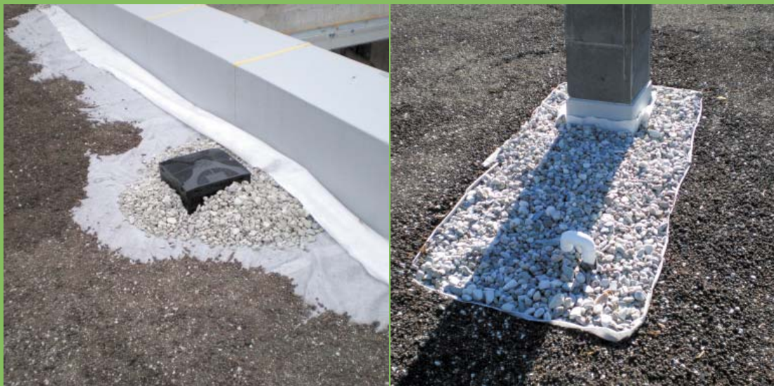
10, 11 | Šachta vtoku, okraj střechy a prostup komínu obsypán práným kamenivem. Substrát a kamenivo je odděleno filtrační textilií
